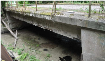
Abb. 1: stark geschädigtes Brückenbauwerk
