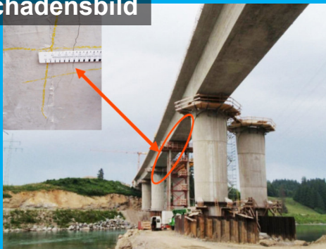
Riss-Schaden an Brückenuntersicht
